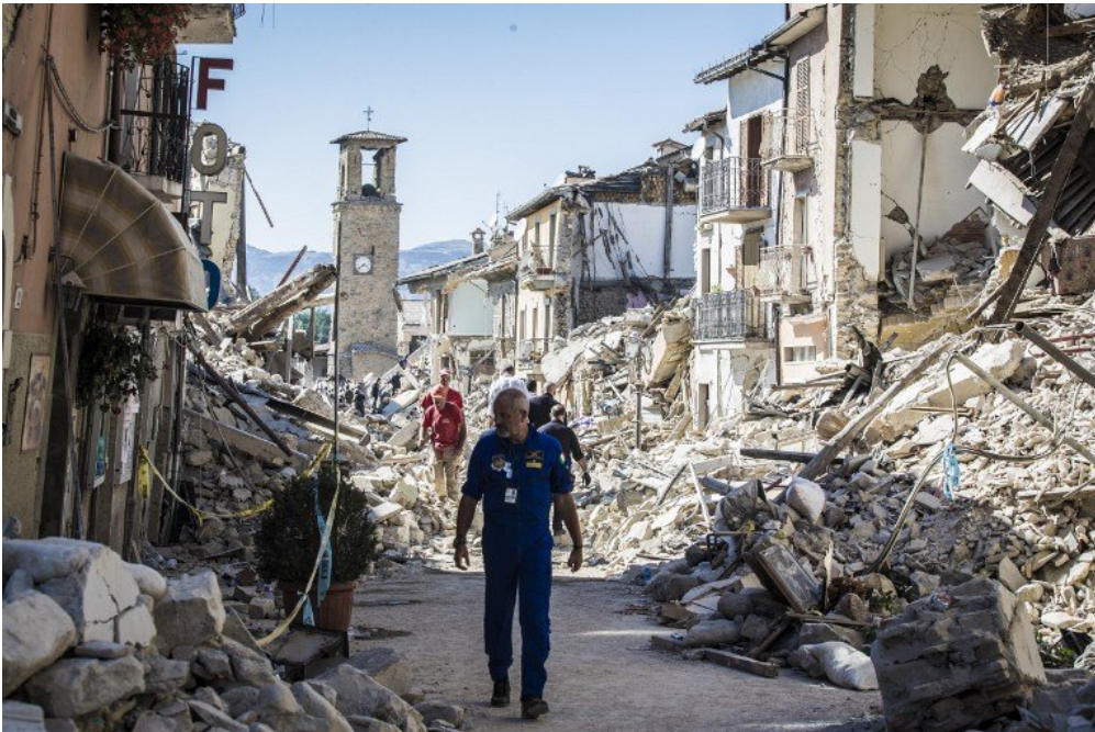
Dans le village d'Amatrice, le tremblement de terre du 24 août a détruit une grande partie de la ville, composée d'anciennes habitations. © Romano/ NurPhoto/ AFP
